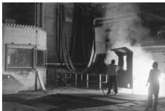
Bild 30: Steuerraum (links) eines Elektroofens (rechts).
