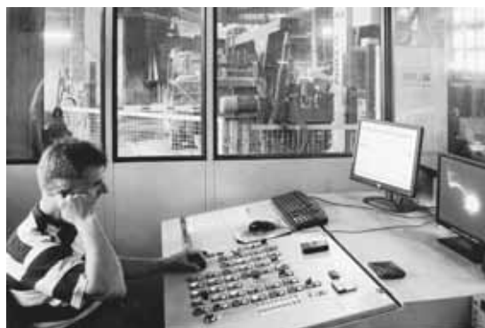
Bild 29: Steuerraum in der Formerei einer Giesserei.
