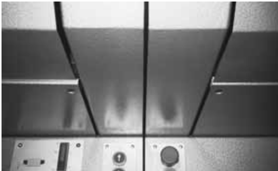
Bild 43: Undichte Kapselung an einer Buchbindereimaschine.
