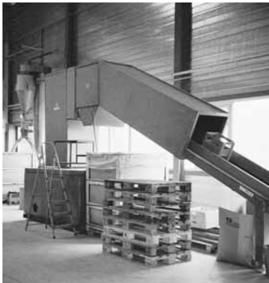
Bild 20: Kunststoffmühle für gebrauchte Getränkeharassen. Das Förderband für den Transport des Mahlgutes (rechts) ist als Schalldämpfer ausgebildet. Das entstandene Granulat wird über eine Rohrleitung abgesaugt. Die Kapselung besteht aussen aus 1,5 mm dickem Stahlblech, innen aus 50 mm Mineralwolle und Lochblech.
